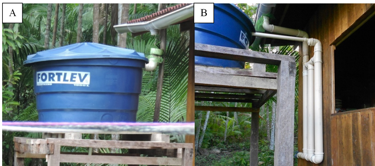
Figura 2 – Sistema de descarte da primeira água da chuva. Cisterna com sistema manual (A); Cisterna com sistema semiautomático (B)
